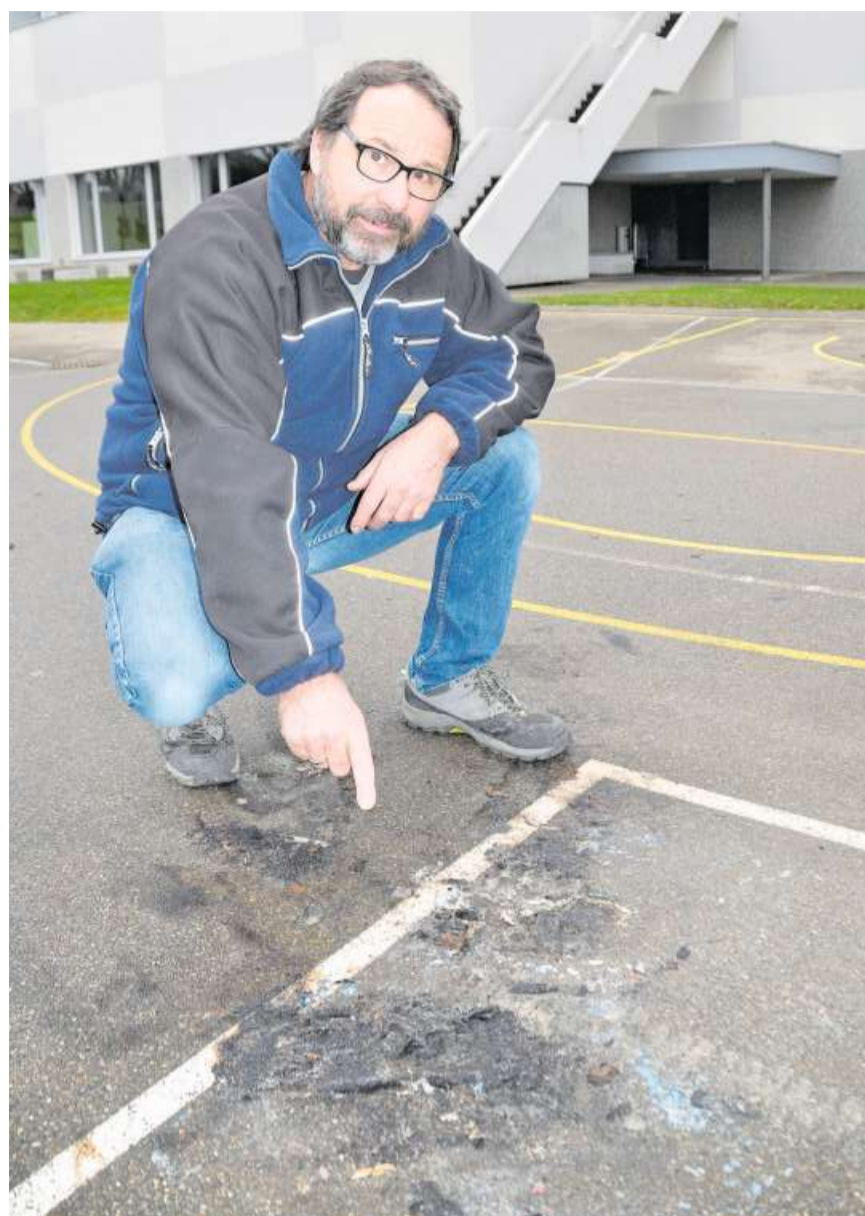
Hausdienstleiter Daniel Mathys auf der Basketballanlage, wo Feuerwerkskörper den Asphalt massiv beschädigt haben. (Bild -ter.)
