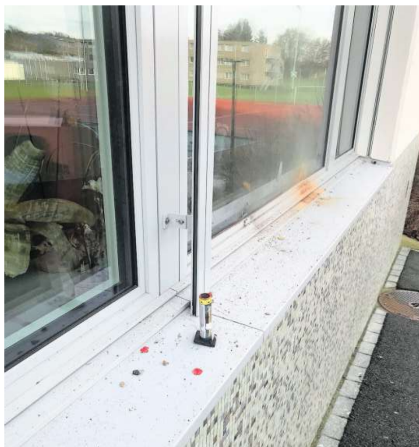
Eine beschädigte Fensterfront. (Bild zvz.)
